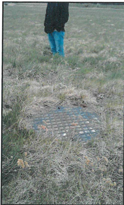
Rys. 2. Uszkodzony drenaż w pkt. 2.
