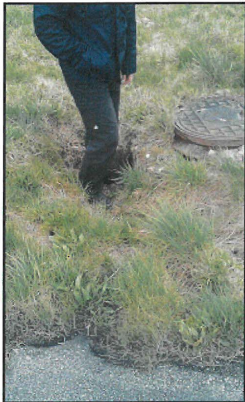
Rys. 4. Uszkodzony drenaż w pkt. 4.
